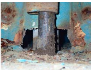
写真-4 PC損傷状況
