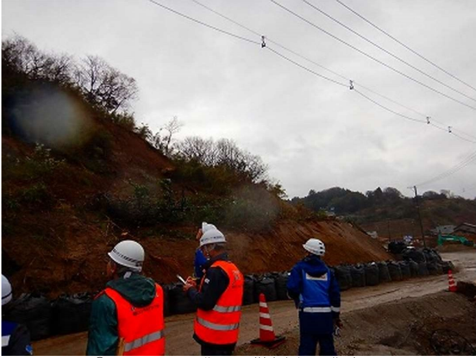
③-3 20240118 国道249号 (輪島市大野町菰沢) .jpg
