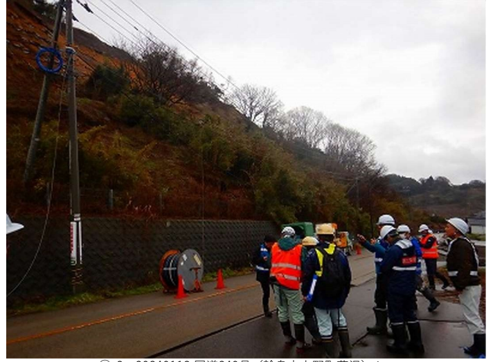
③-2 20240118 国道249号 (輪島市大野町菰沢) .jpg
