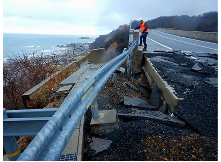
④-1 20240118 国道249号 (珠洲市馬蝶町) .jpg
