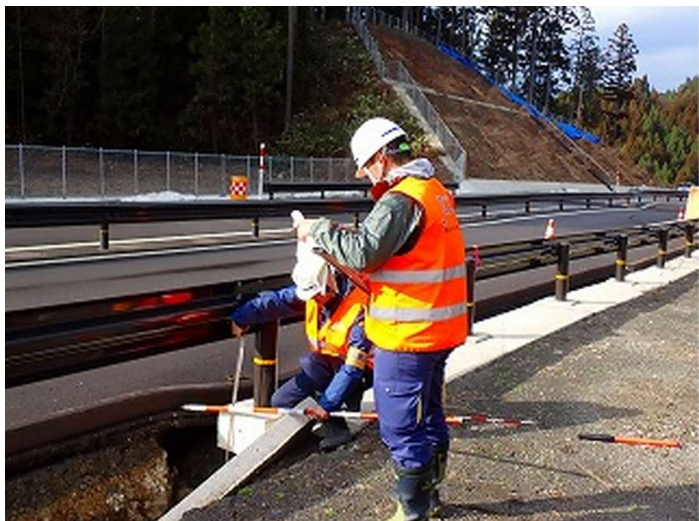
⑦-3 240215_路面被災状況調査_国道470号輪島道路（三井町）.jpg
