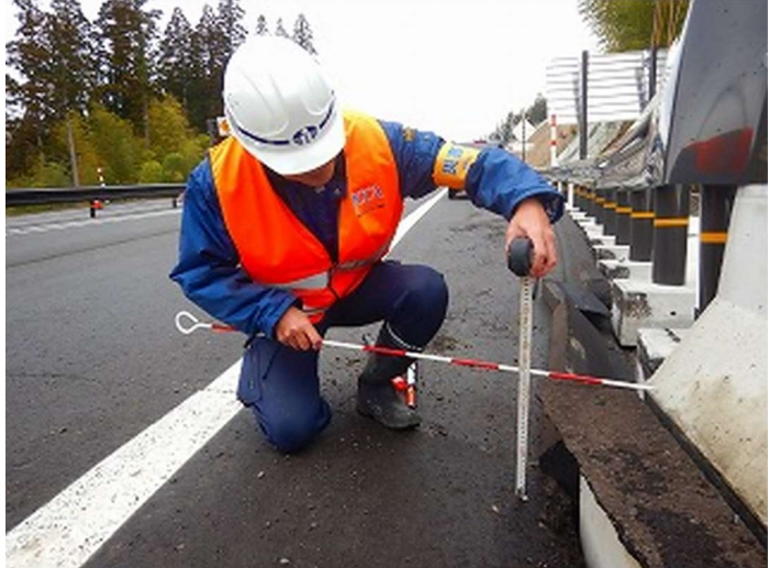
⑦-1 240215_路面被災状況調査_国道470号輪島道路（三井町）.jpg
