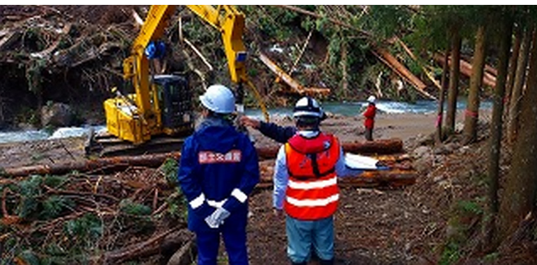
⑧-1 240307_斜面崩壊に伴う河道閉塞調査_河原田川 (輪島市熊野地先) .jpg
