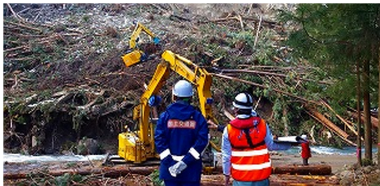
⑧-2 240307_斜面崩壊に伴う河道閉塞調査_河原田川 (輪島市熊野地先) .jpg
