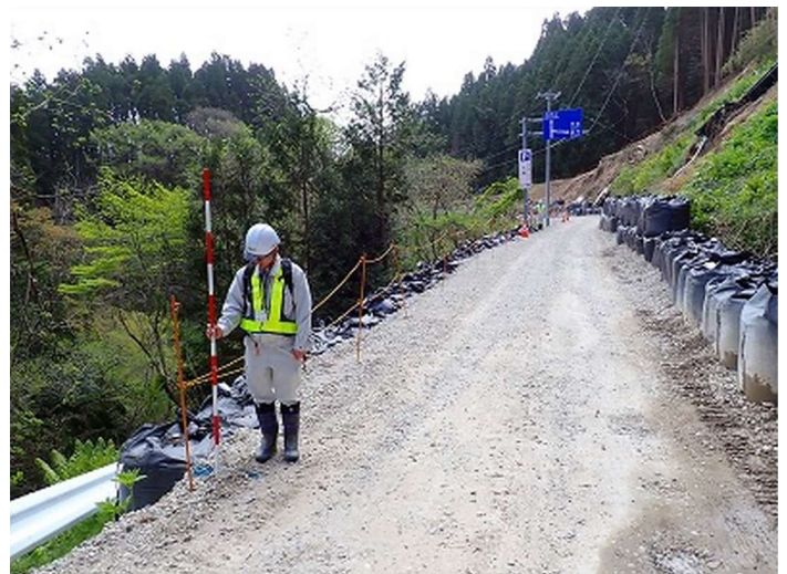
⑪-8 240423_38号和島浦上線_奥能登土木事務所.jpg
