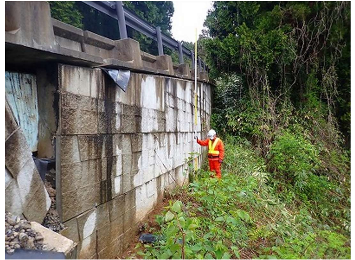
⑪-12 240424_266号五十洲亀部田線_奥能登土木事務所.jpg
