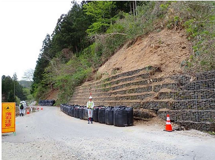
⑪-3 240423_38号和島浦上線_奥能登土木事務所.jpg
