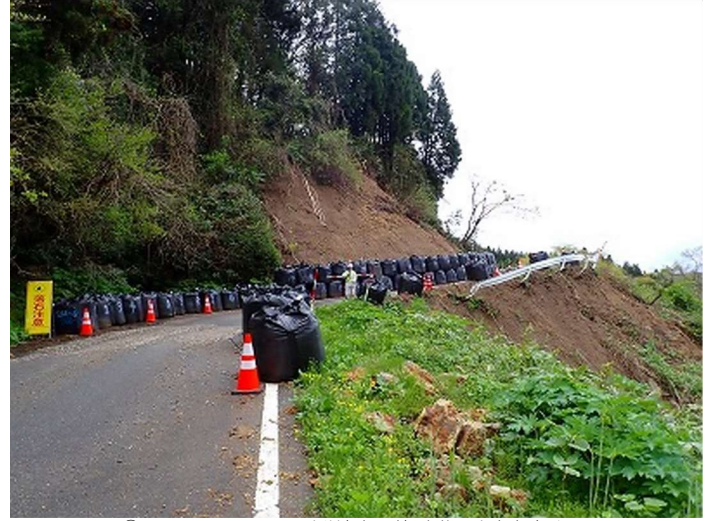
⑪-10 240424_266号五十洲亀部田線_奥能登土木事務所.jpg
