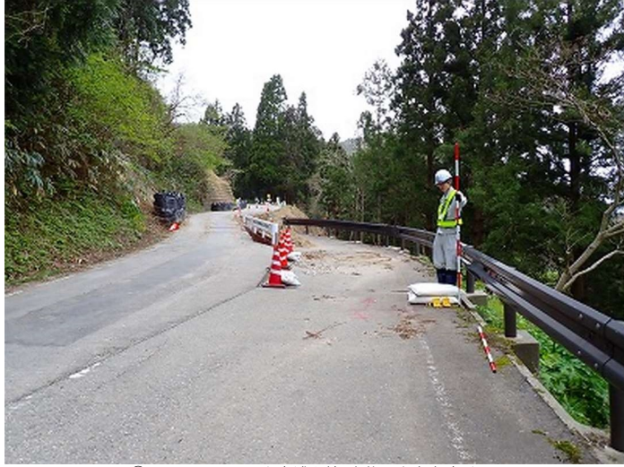
⑪-1 240423_38号和島浦上線_奥能登土木事務所.jpg
