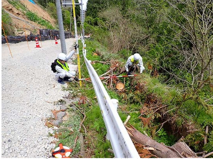
⑪-9 240423_38号和島浦上線_奥能登土木事務所.jpg
