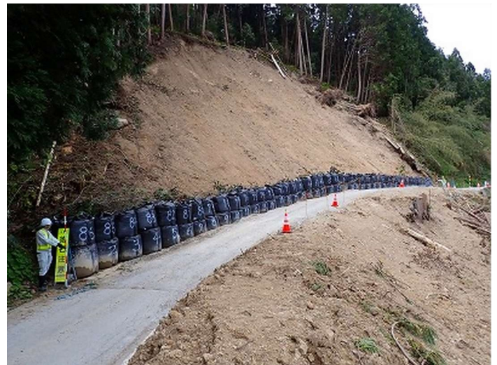
⑪-6 240423_38号和島浦上線_奥能登土木事務所.jpg
