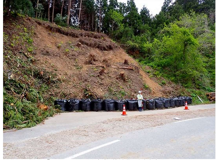
⑪-2 240423_38号和島浦上線_奥能登土木事務所.jpg
