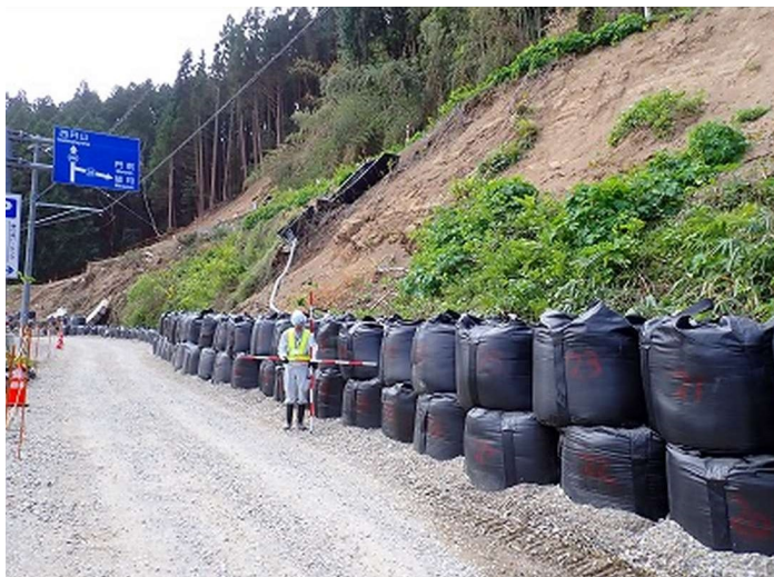
⑪-7 240423_38号和島浦上線_奥能登土木事務所.jpg
