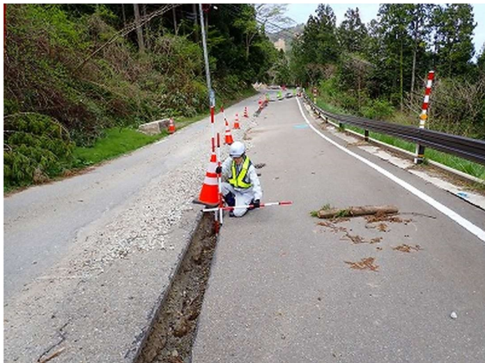
⑪-5 240423_38号和島浦上線_奥能登土木事務所.jpg
